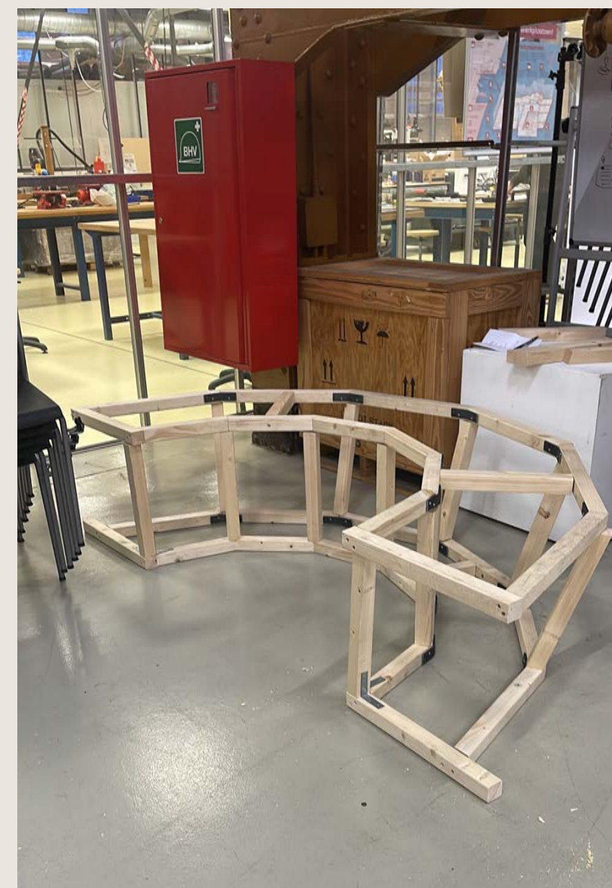
Frame in elkaar geschroefd. Volgende stap is het maken van de zitting en het bevestigen van de triplex bogen.
