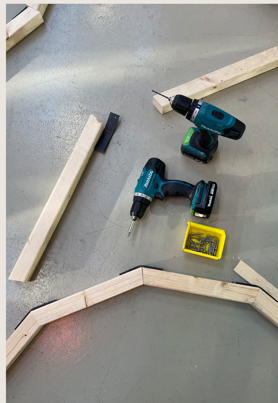
Onderstel aan elkaar monteren, de elementen worden aan elkaar bevestigd door middel van de gemaakte koppelplaatjes.
