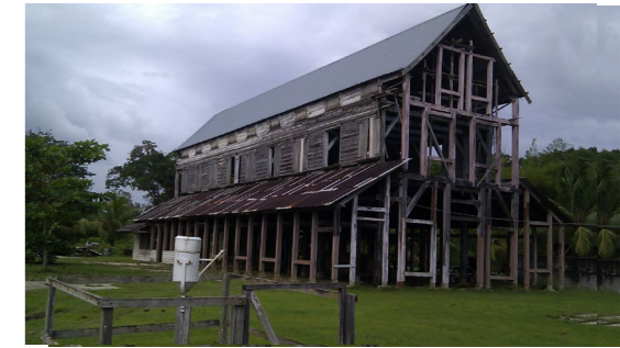
3. principe houtconstructie suikerloodsen (dekbalkgebint) 6. zinken dak, zonder dakgoot. Nostalgie aan de regen
