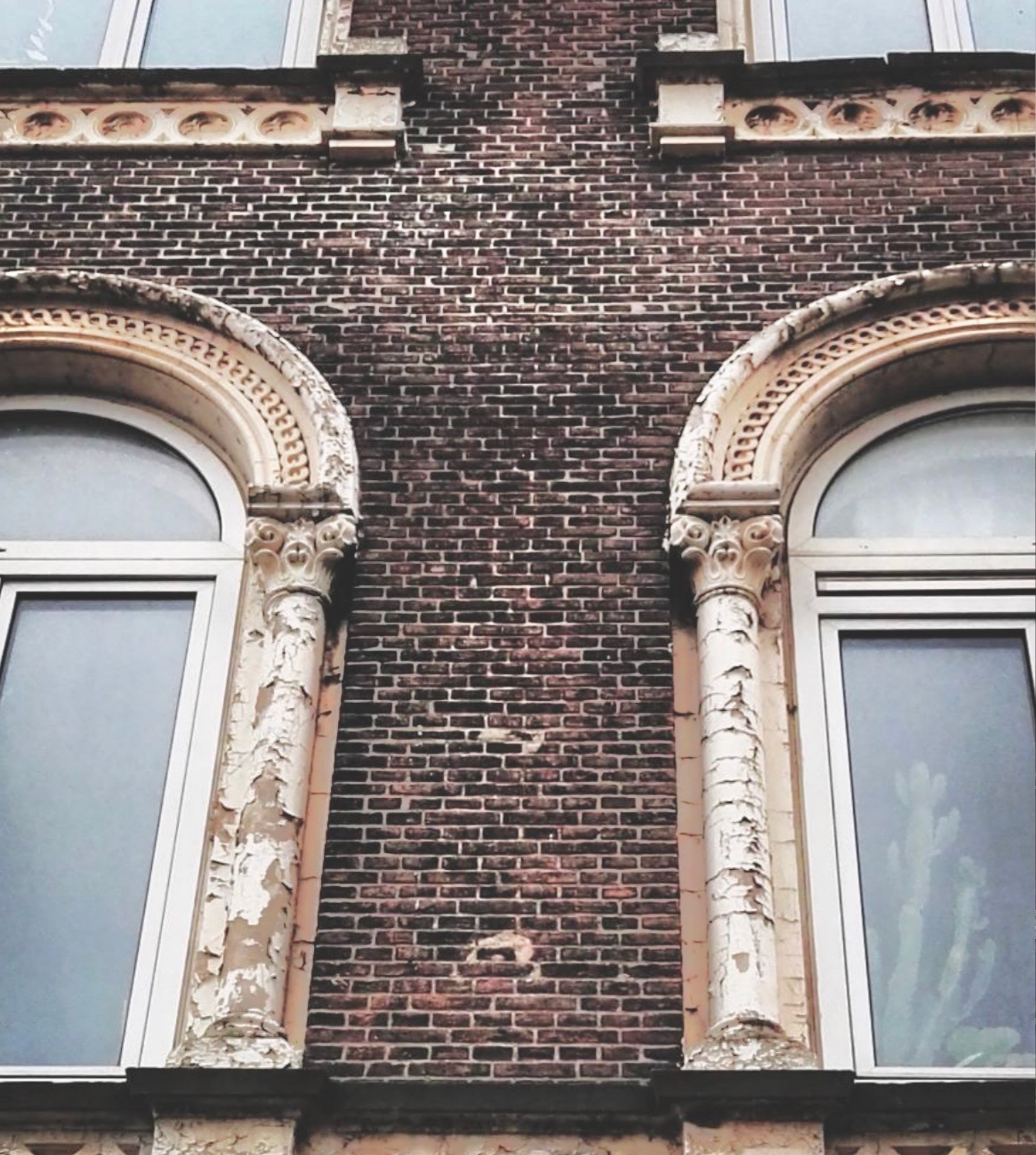
Poortgebouw Voldoet niet
